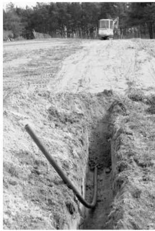
275 Meter Wasserrohre sorgen für die Bewässerung.
